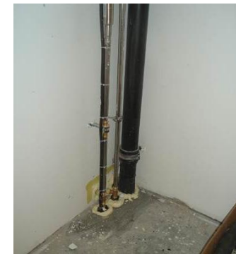
Neue Steigzone Reduit - Leitungen offen zugänglich
